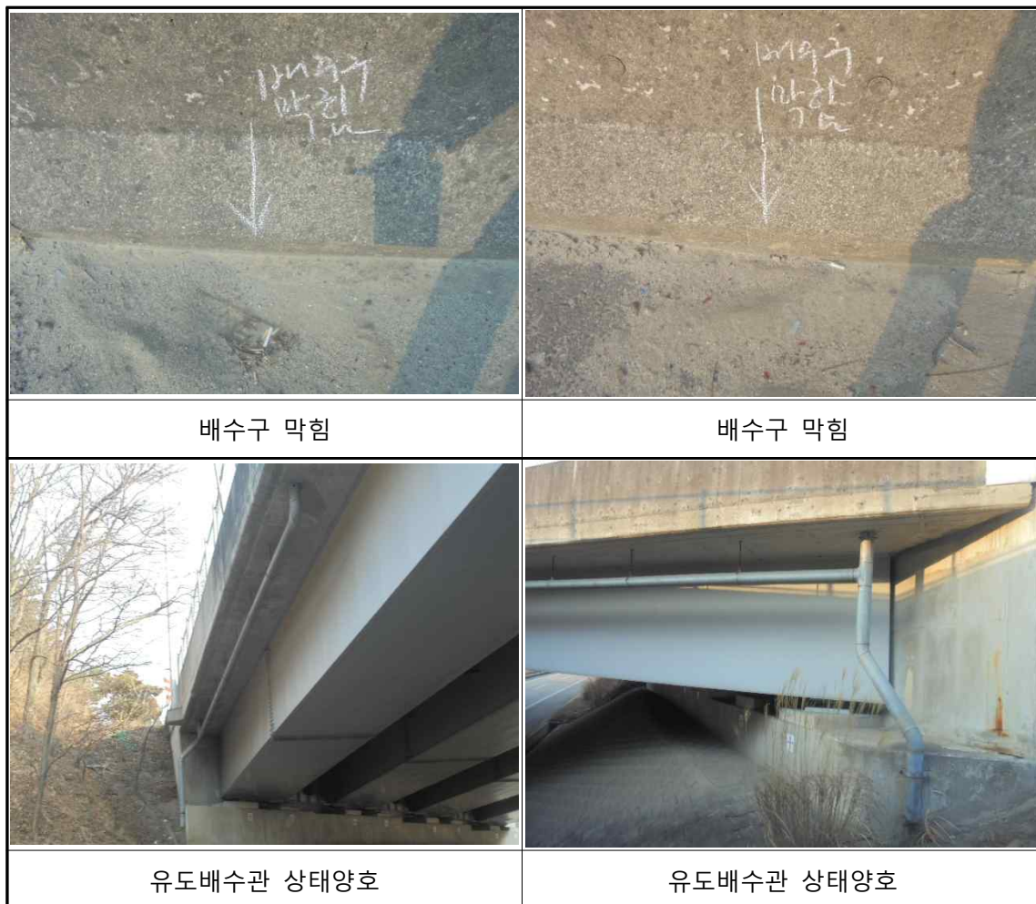
【표 3.3】 중군육교 배수시설 손상물량
