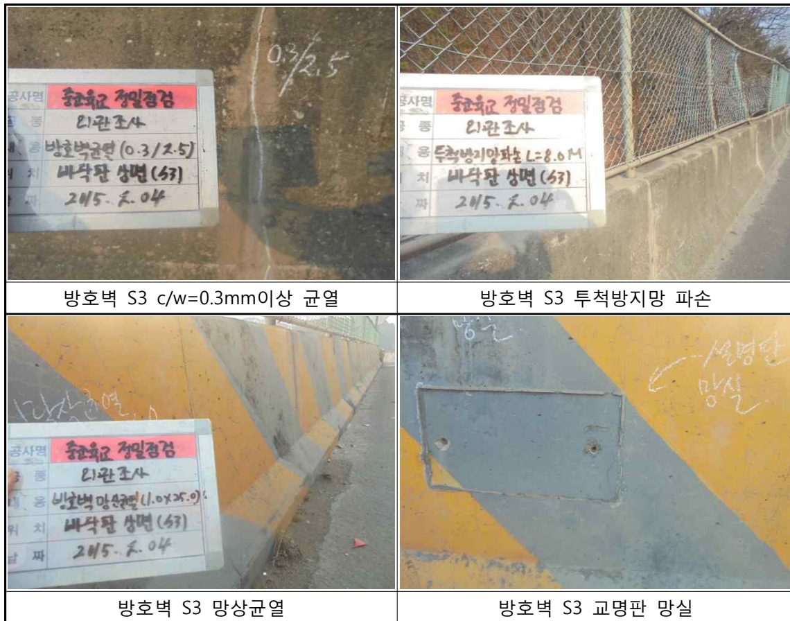
【표 3.4】 중군육교 방호벽 손상물량
