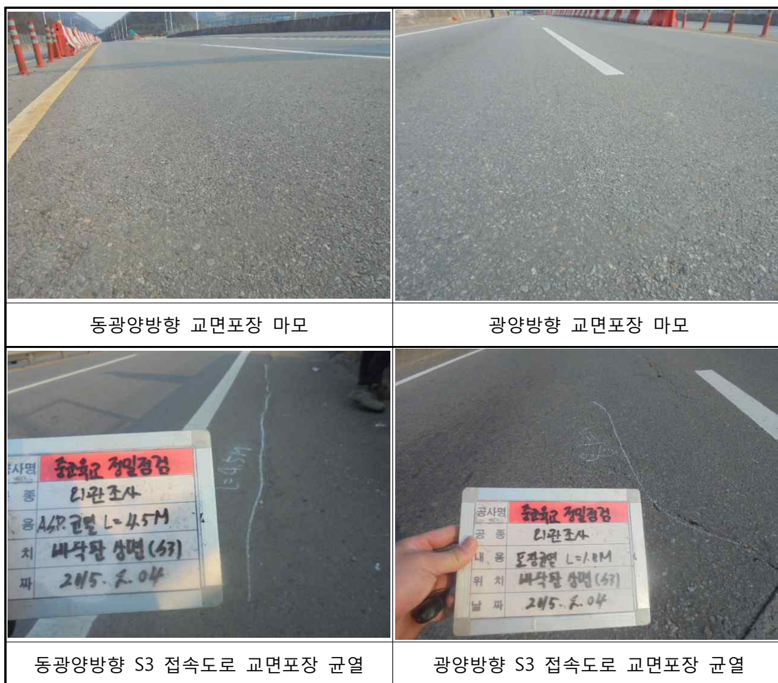
【표 3.2】 중군육교 교면포장 손상물량
